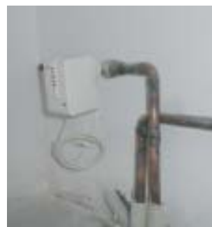
Les TF 501 sont placés dans les placards techniques
