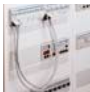
Nettverksforbindelser med ferdigkonfeksjonert patchekabel
