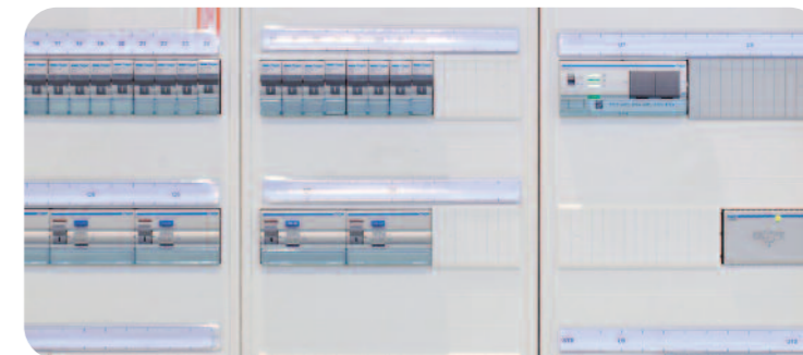
Bewuste keuzes op het gebied van energievoorziening en gebouwautomatisering zorgen voor een efficiënt pand.
