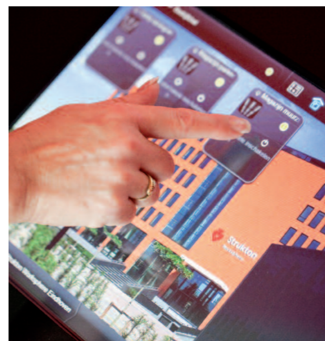
Centraal bij de balie zijn eveneens alle onderdelen van de installatie te bedienen.
