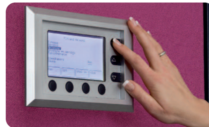
Voor de centrale bediening van de installaties bij de receptie leverde Hager een lcd-scherm. Met enkele knoppen is de verlichting en de klimaatinstallatie in alle ruimten van het centrum aan te sturen, door alle collega's.
