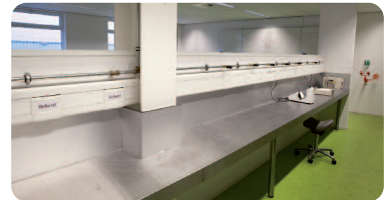
Alle aansluitingen zijn netjes en veilig weggewerkt achter deksels met de inline contactdozen.
