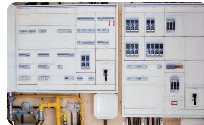
Hager Paneelbouwpartner Thijssen Oomen zorgde dat de omvangrijke verdeelinstallatie, met alle KNX-componenten, op tijd en op de juiste wijze werd geprefabriceerd en op de bouwplaats werd aangeleverd.
