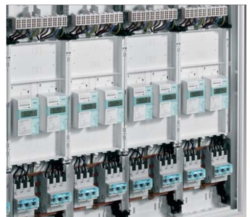
Die neuen eHZ-Zähleranlagen sind übersichtlich aufgebaut. Die Zuordnung der Kundenanlage ist eindeutig.
