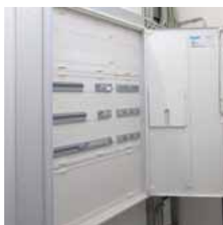
Hlavní rozvaděč v budově Voithu také od firmy Hager.
