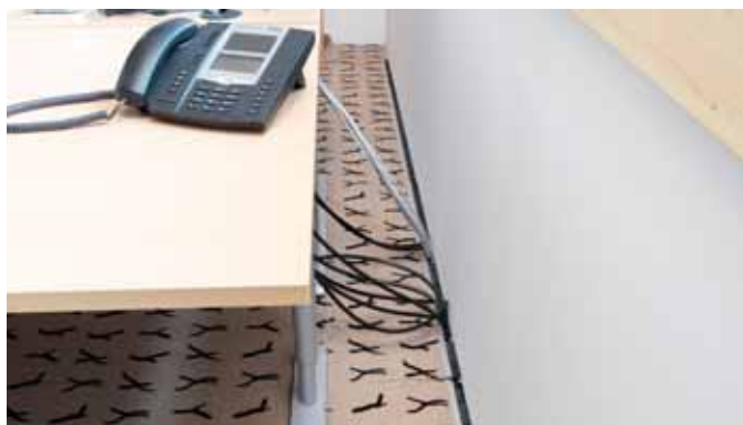
Kabely jsou do místnosti vyvedeny u stěny přes výstupní hřeben tehalit BKB.
