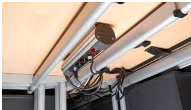
Moduly tehalit pro připojení stolů zajišťují pomocí dvou zásuvkových okruhů bezpečné napájení elektrickou energií.
