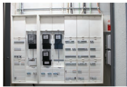
Srdce elektroinstalace: elektroměrová skříň Hager s modulárními jističi a spínači.
