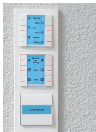
Pro přehledné ovládání světel a žaluzií byly do programu spínačů kallysto® namontovány tlačítkové snímače KNX a popsány softwarem Semiolog v modré firemní barvě.
