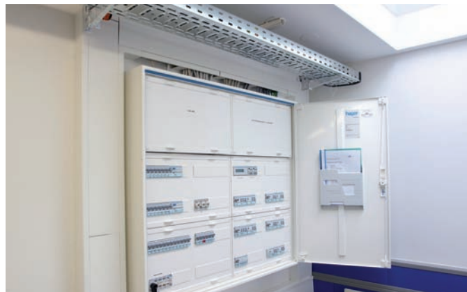
Nový podružný rozvod poskytuje místo mimo jiné pro meteorologickou stanici Hager.
