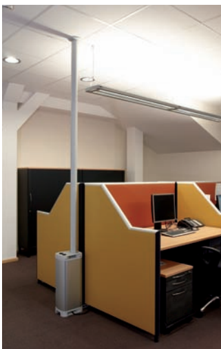
Každý sloup zajišťuje osmi pracovištím celkem 16 přípojek.
