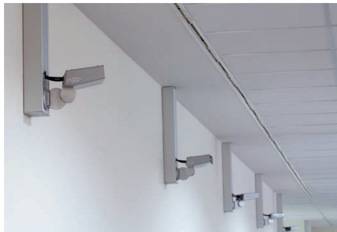
Automatický systém větrání integroval elektrotechnik do speciálně upravených kusů systému parapetních kanálů tehalit. BRA.
