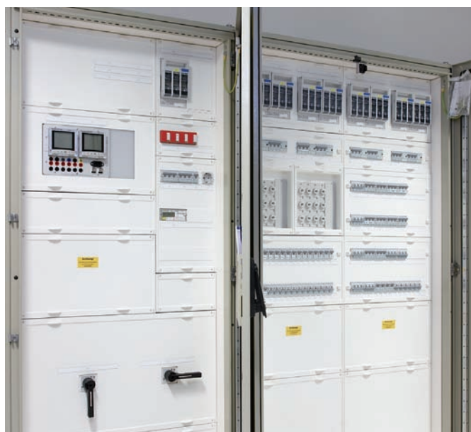
Hlavní rozvaděč 630 A s kontrolou diferenčního tlaku v řadových rozvaděcích Hager FG2...WN.
