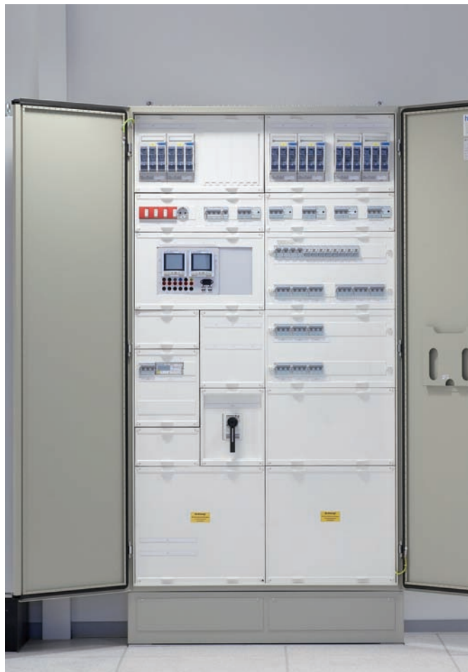
Podružný rozvaděč 250 A s kontrolou diferenčního proudu v samostatně stojících rozvaděcích Hager FA24E.
