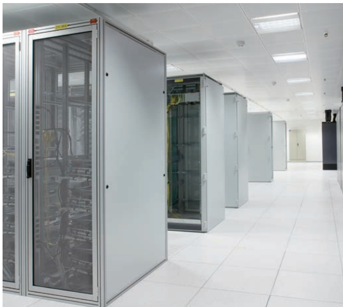
Napájení serverových skříní T-Systems probíhá pomocí rozvaděčů Hager.
