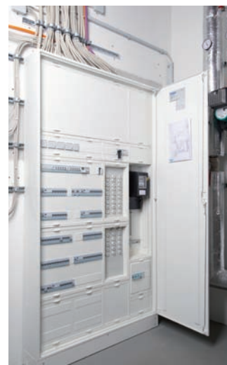
Vše od jednoho dodavatele: modulární jističe, spínače a komponenty tebis KNX umístil elektrotechnik ve smyslu systémové myšlenky do hlavního rozvaděče Hager.
