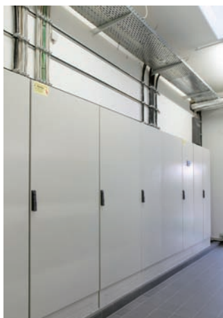
V rozvaděčových skříních od firmy Hager je uloženo srdce elektrotechnické instalace fitness studia.
