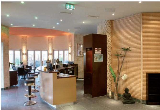
Regulace světla a teploty v místnostech probíhá přes vizualizaci Hager s dotykovým panelem v prostoru recepcce.
