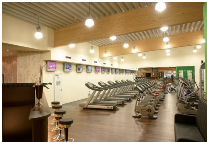
Elektroinstalace je ve studiu integrována tak, že svými rozličnými funkcemi zajištuje komfort a radost ze sportu.
