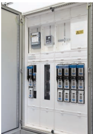
Také nepřímé měřicí zařízení k měření 110 kW fotovoltaického zařízení je umístěno v samostatně stojících rozvaděcích Hager.
