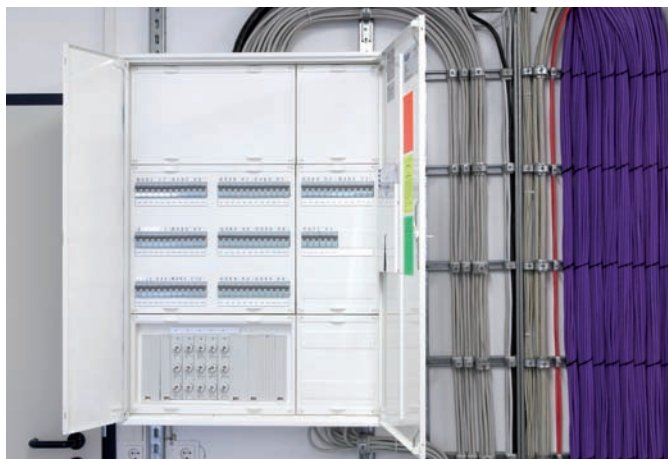
Nástěnný rozvaděč Hager včetně modulových jističů a spínačů tvoří „srdce“ elektroinstalace.
