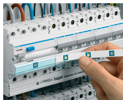
Obr. 4. Jednoduché a rychlé označení přístrojů pomocí popisového štítku s průhledným krytem.
